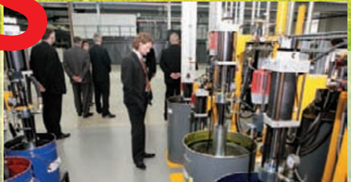
Ein geschlossenes System: die zentrale Farbversorgung bringt die vier Skalenfarben Cyan, Magenta, Yellow und Black über Leitungen direkt an die Druckmaschinen.
